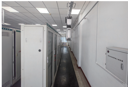
轨道机器人巡检
